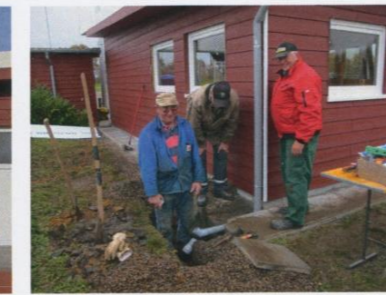
03.11.2016 Keine Überschwemmungen mehr. Die Entwässerung läuft.
